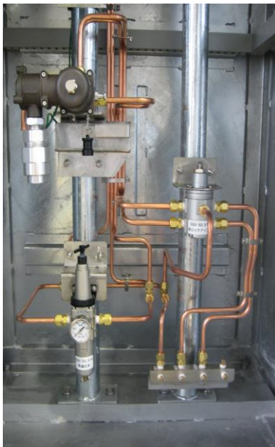
電磁弁・減圧弁収納盤 空気配管チュービング(銅管6.8Φ)
